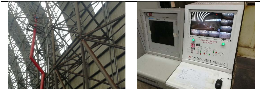
摄像监控与火灾报警控制系统
